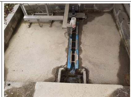
Canal venturi sortie traitement
