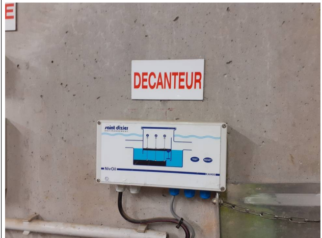
Alarme du décanteur (lavage engins)
