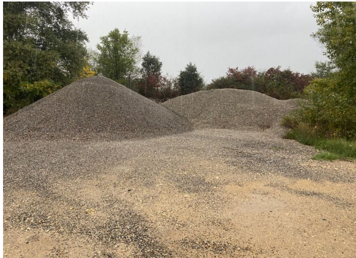
Photo n°3 – stockage des matériaux à l'air libre
