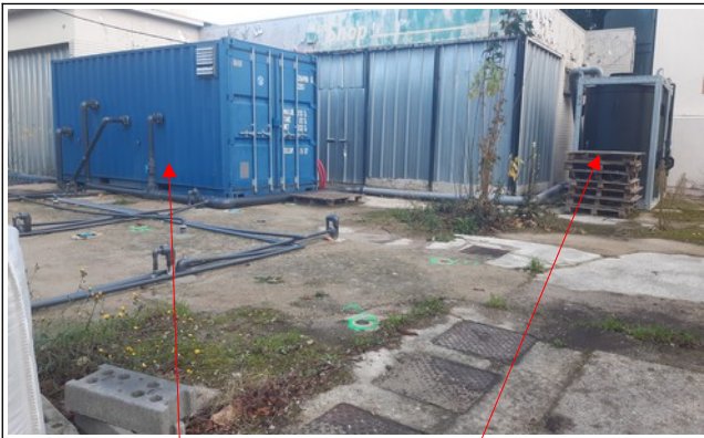
Caisson de traitement et filtres à charbon actif
