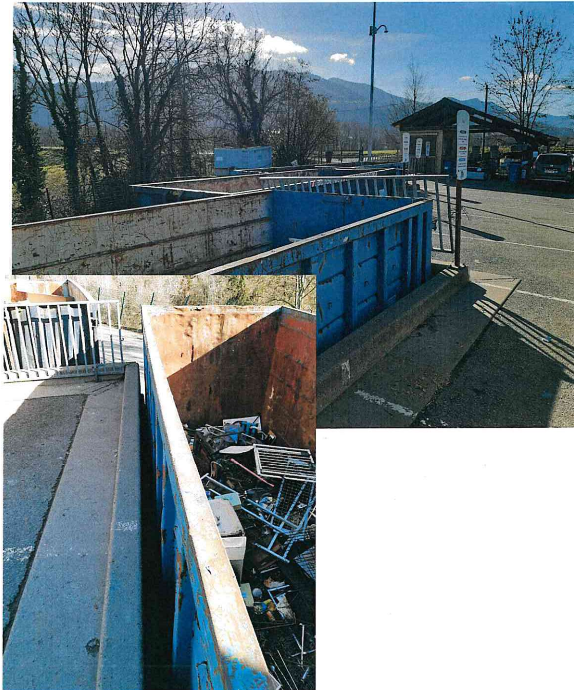
Absence de Garde-Corps du quai haut
