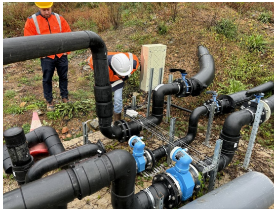
Raccords casier B7 au réseau lixiviât / ERI
