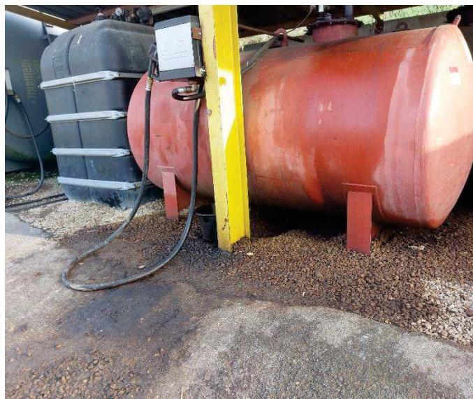
4 Cuves à fuel et gazole avec traces au sol au niveau du dépotage
