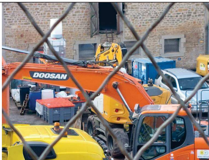
Stockage 1 container bleu 10 m 3
