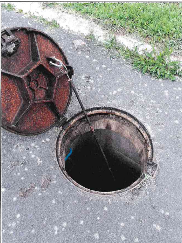
trappe vanne bassin d'orage
