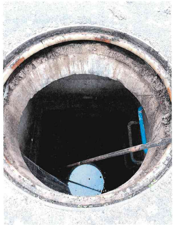
trappe vanne bassin orage ouverte
