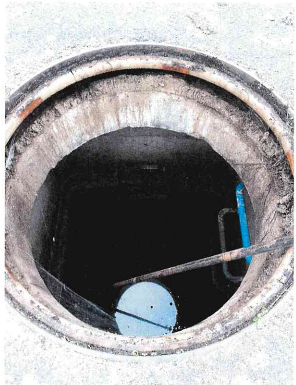
trappe vanne bassin orage ouverte
