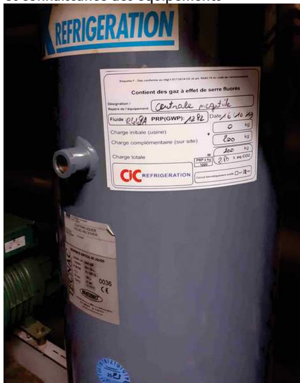
Étiquetage apposé sur la centrale négative
