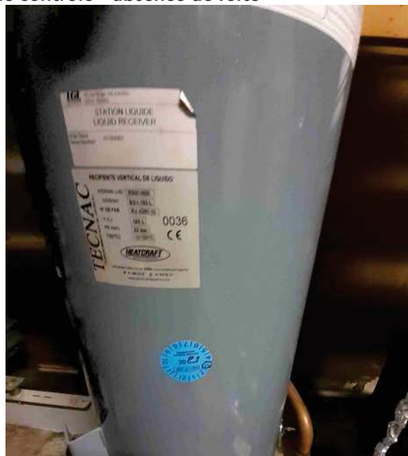
Marque de contrôle d'étanchéité apposée sur la centrale négative
