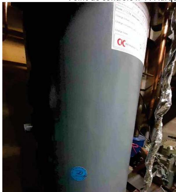
Marque de contrôle d'étanchéité apposée sur la centrale positive
