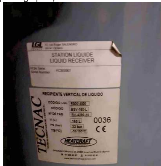
Étiquetage du réservoir de fluide de la centrale négative
