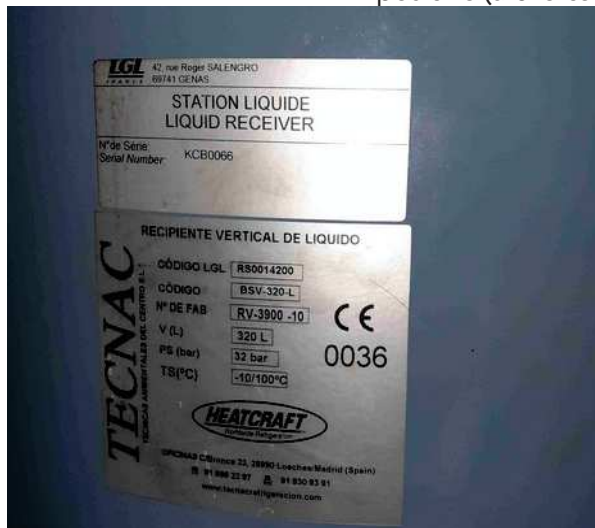
Étiquetage du réservoir de fluide de la centrale positive
