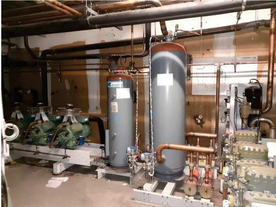
Vue générale des réservoirs de fluide des centrales négative (à gauche sur la photographie) et positive (à droite sur la photographie)
