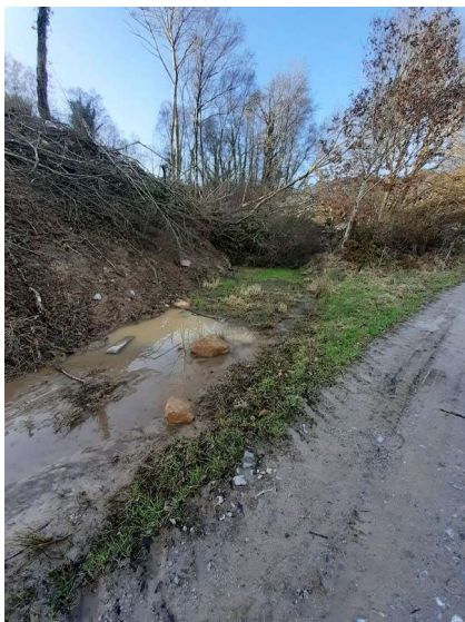
Infiltration des eaux pluviales en point bas de l'installation
