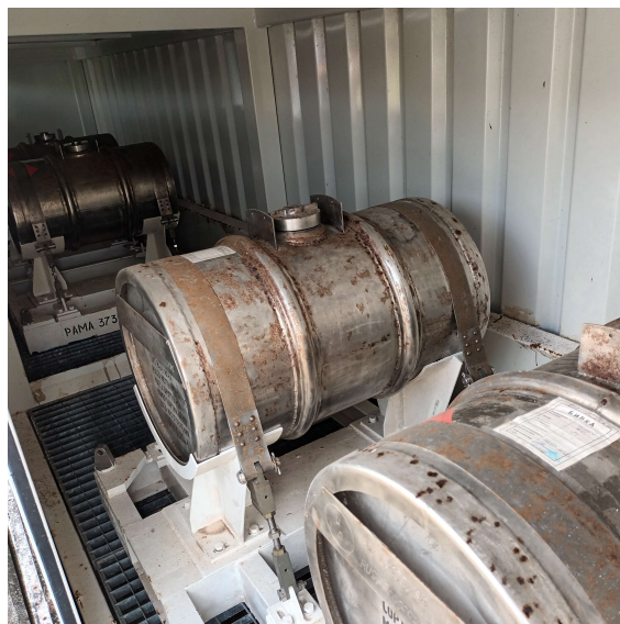
Stockage 3x3 fûts d'éthylcellosolve
