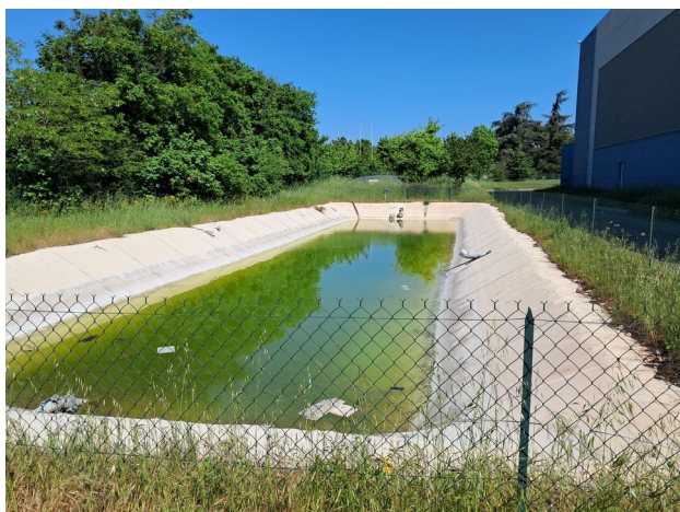
Bassin de la réserve incendie
