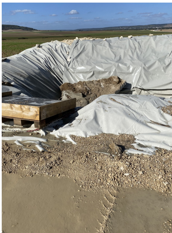
Figure 2: Fosse de lavage des toupies de béton
