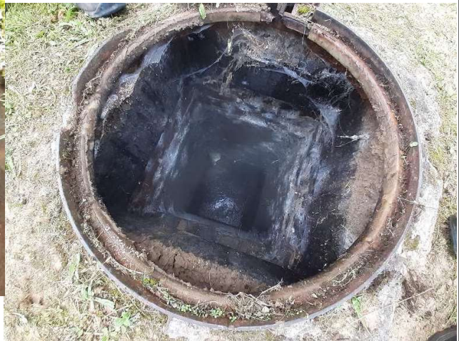
Les effluents sont chauds – de la vapeur se dégage de ce collecteur
