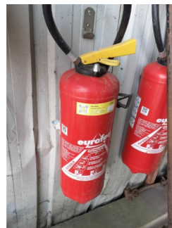
Extincteurs présents à l'extérieur
