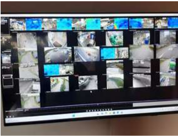
Zone de contrôle des caméras anti-intrusion et thermiques
