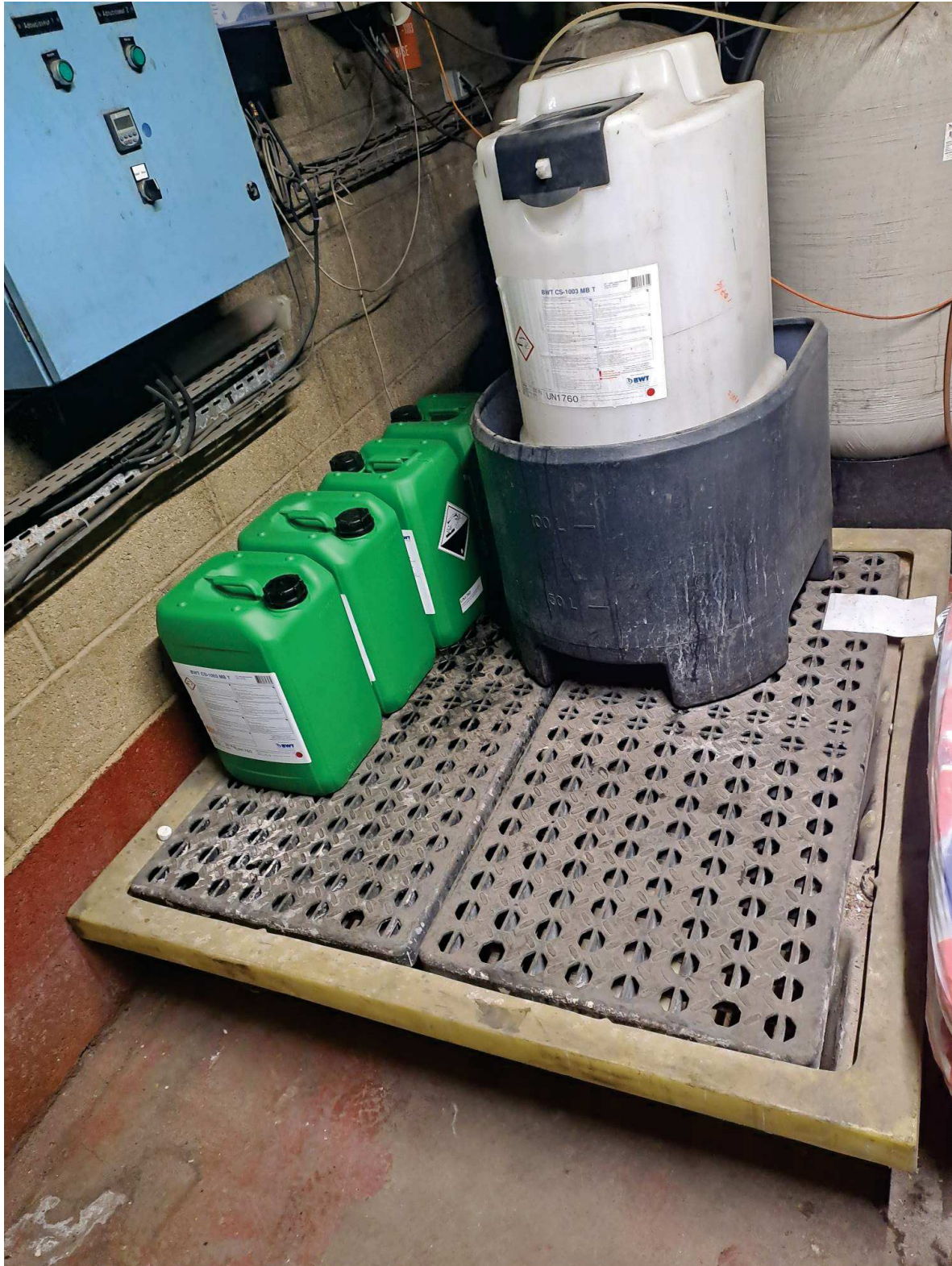
Photographie n°1 – rétention dans le local technique du bâtiment 6 (circuit PMP)
