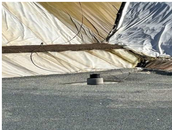
Puit de pompage des lixiviats du casier 5.1
