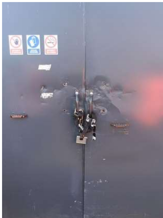
Exemple d'ouvrants régulièrement vandalisé
