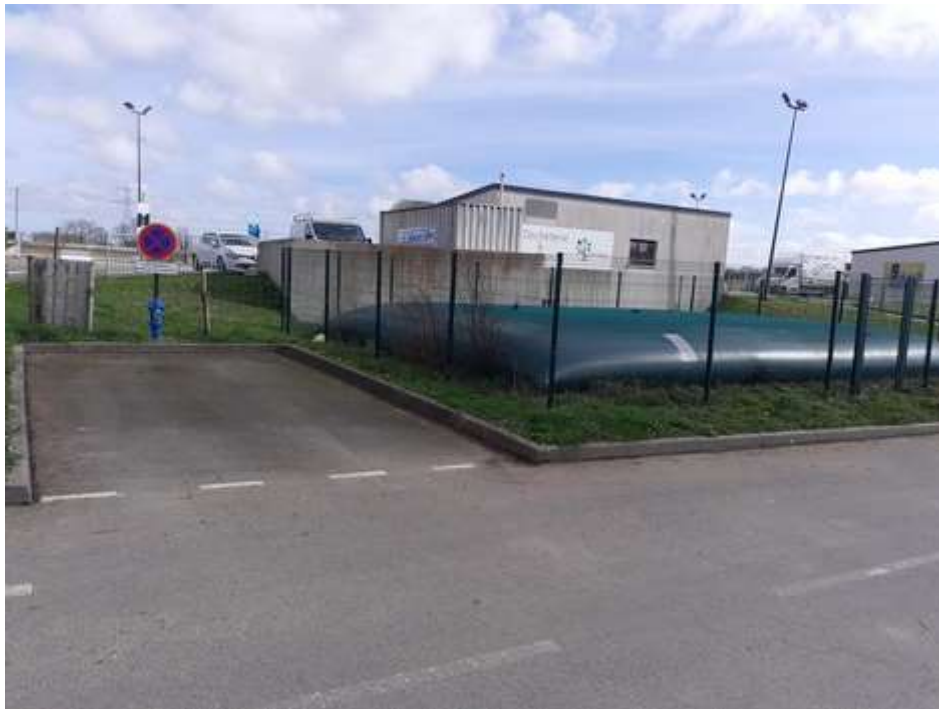
Réserve incendie située au centre de la déchetterie avec une zone de stationnement réservée aux Pompiers
