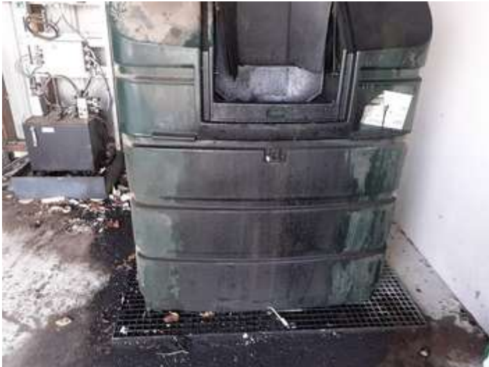
Benne à huile à double enveloppe avec la présence de ruissellement et d'égouttures sur la paroi extérieure
