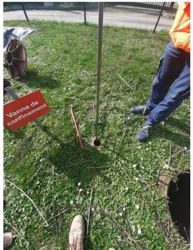
Vanne de confinement
