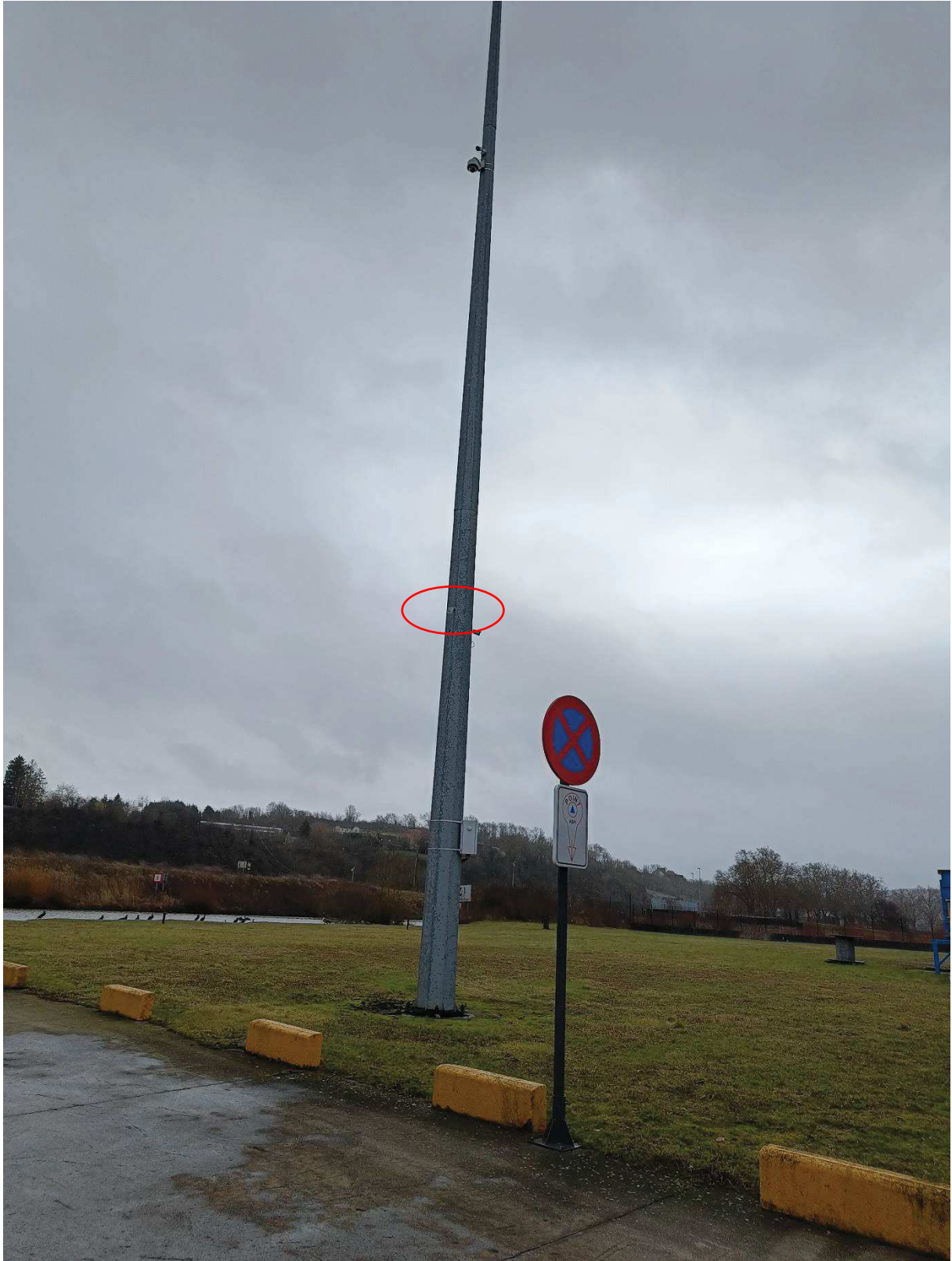
Figure 19 : Marquage à 6m pour identifier les hauteurs des tas
