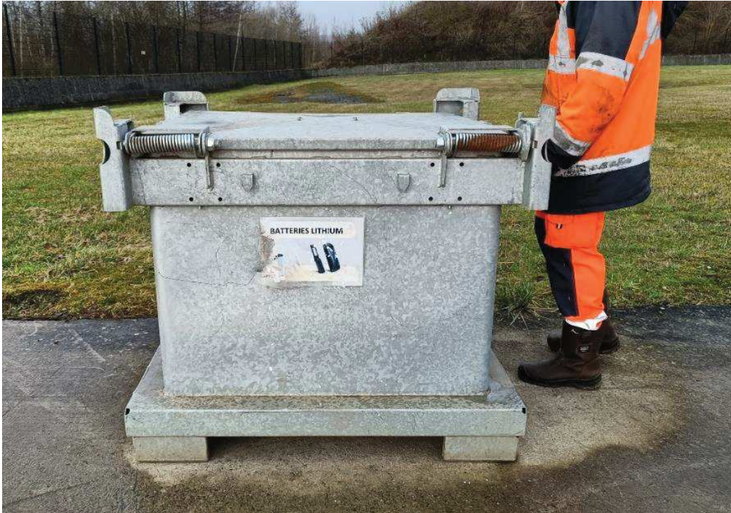
Figure 11 : Le container est conçu pour le stockage de batteries lithium et il est étiqueté
