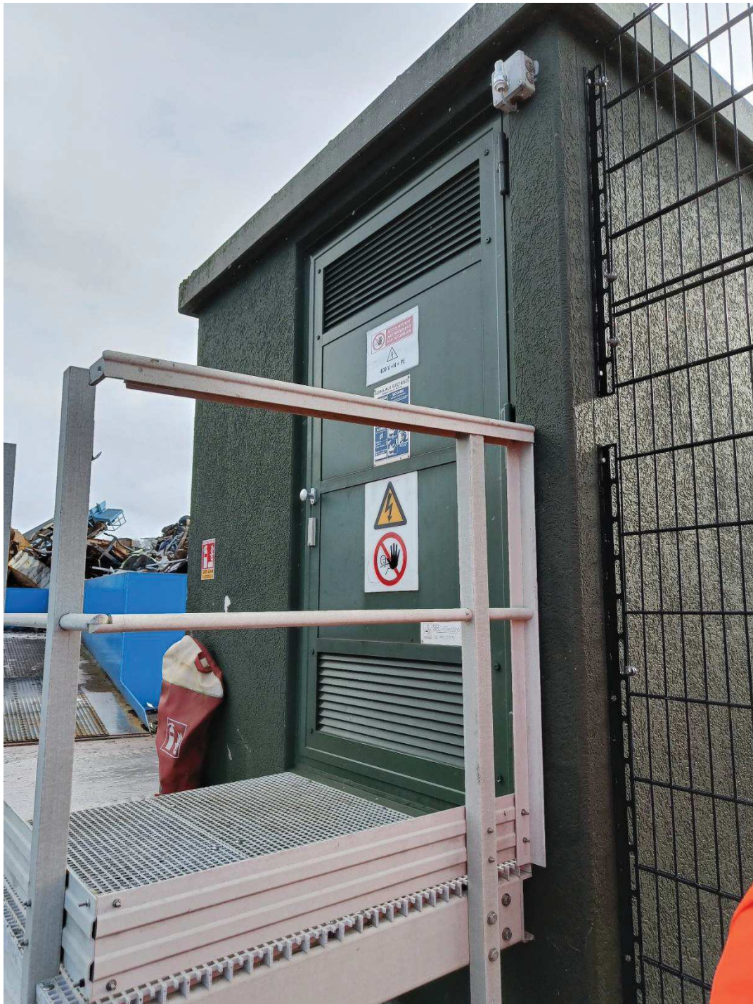
Figure 4 : Accès exploitant pour le transformateur électrique installé en hauteur
