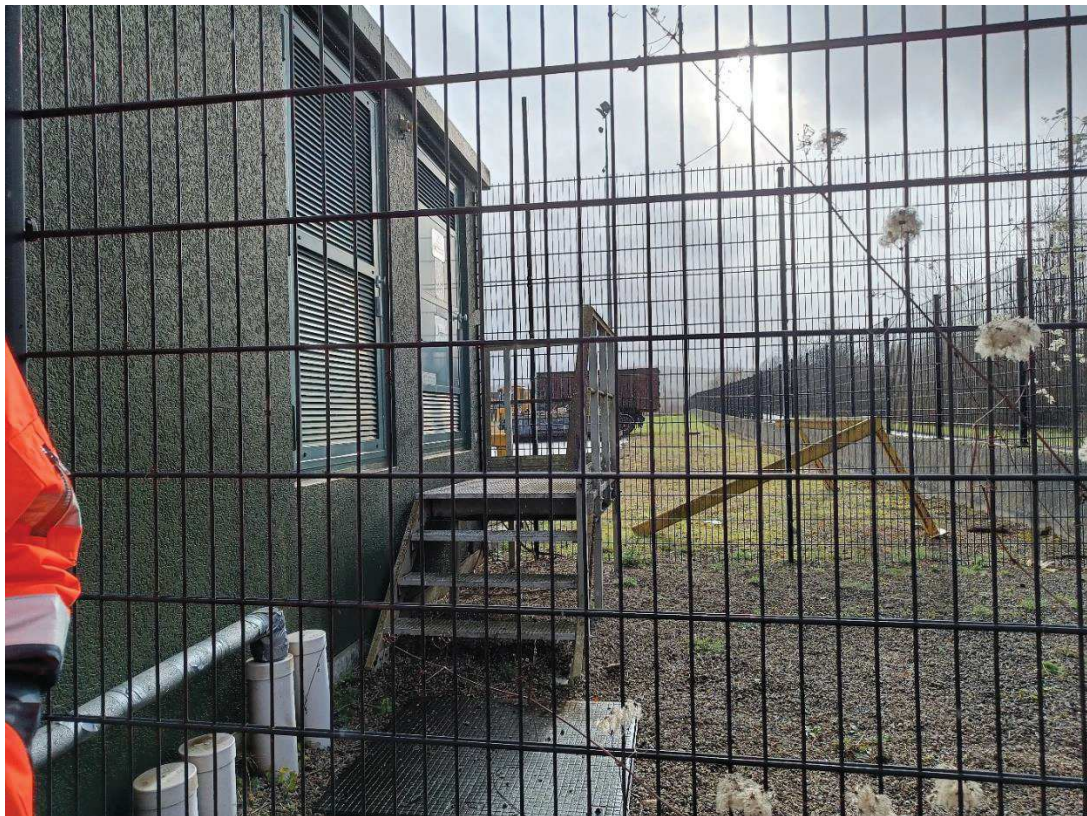
Figure 3 : Accès pompiers pour le transformateur électrique installé en hauteur
