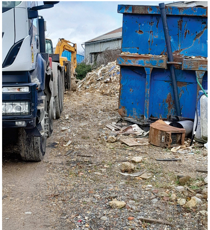
Photo 6 : tas de déchets composés d'un mélange de terre, gravats et de ce qui s'apparente à du plastique, inspection du 30/01/25
