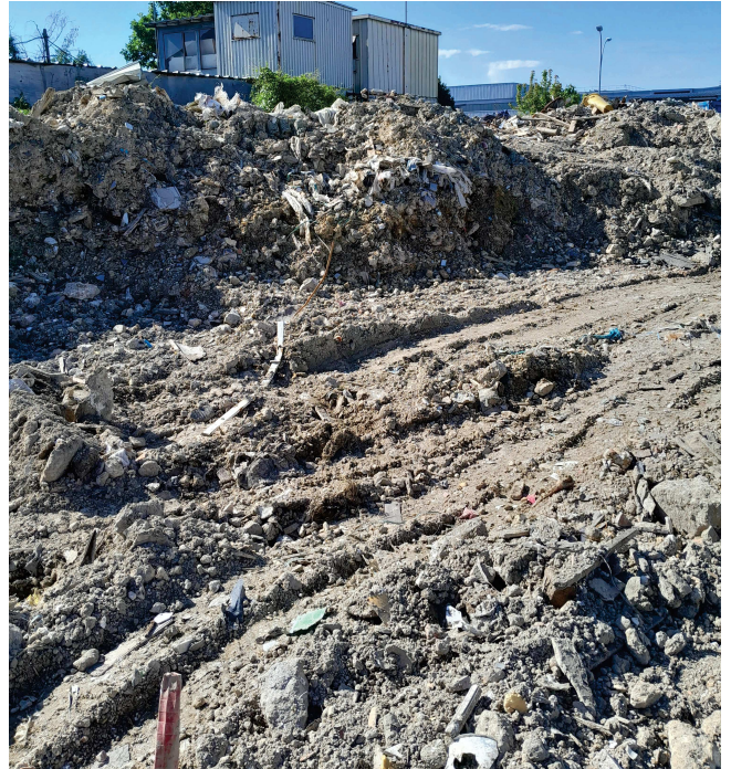
Photo 2 : vue d'un tas de déchets, 1 er inspection du 07/05/24
