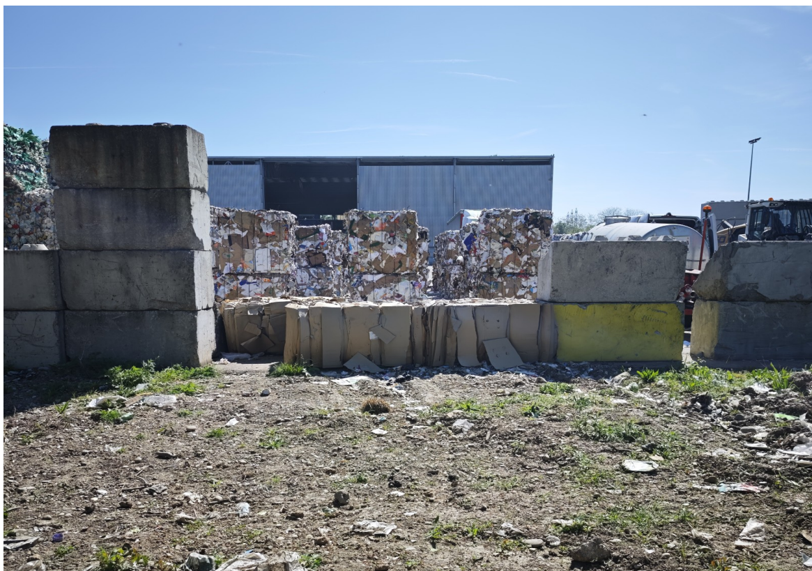
Mur béton non jointif, hauteur du mur non égale en tous points et présence de balles cartons en lieu et place de blocs bétons
