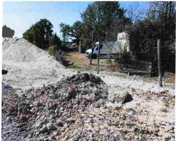
Remblai sur la parcelle de l'exploitant recouvrant la fosse septique (borne : piquet bois rouge)
