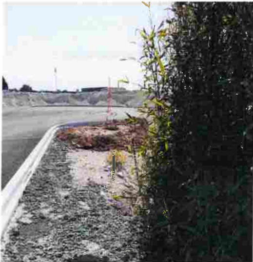
Travaux de voirie avec dépôt de remblai au-delà du bornage parcellaire de l'exploitant (piquet en bois)
