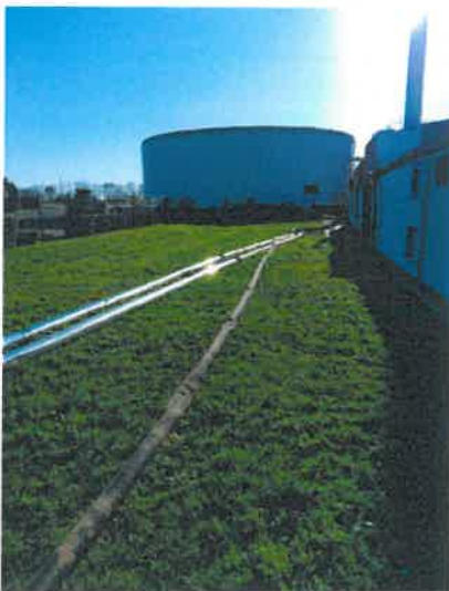
Tuyau mis en place pour pomper le digestat de BT04 vers le bassin eaux pluviales (réaffecté en bassin de rétention lors de l'incident)
