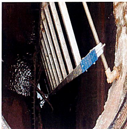
Vanne de confinement (1/2)
