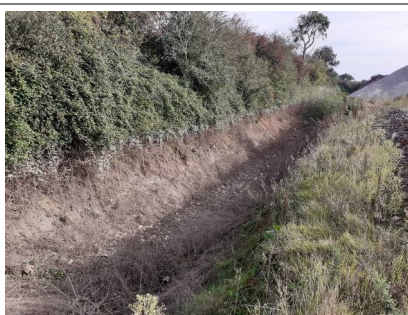
Noue de collecte des eaux pluviales de l'établissement
