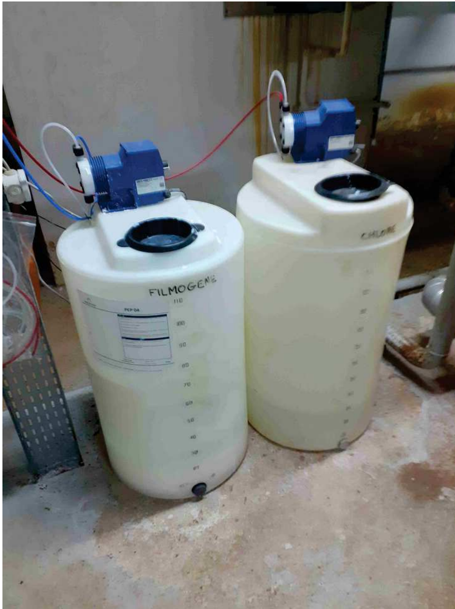
Fûts de stockage de produits associés au traitement de l'eau
