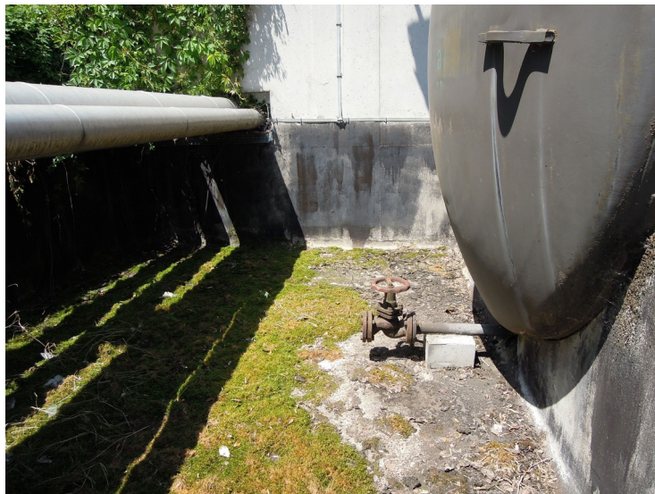
Fond de la cuvette de rétention de la cuve de Fioul domestique partiellement recouverte de mousse
