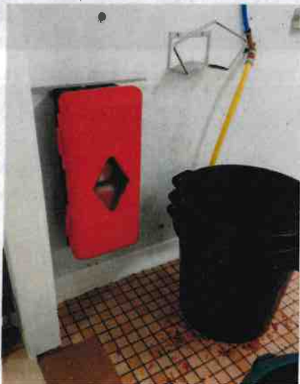
Extincteur en salle de plumaison
