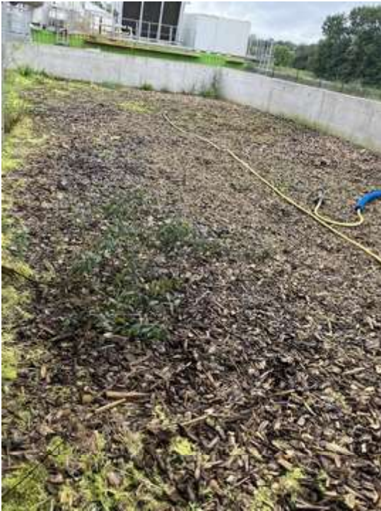
Biofiltre de l'unité de désodorisation
