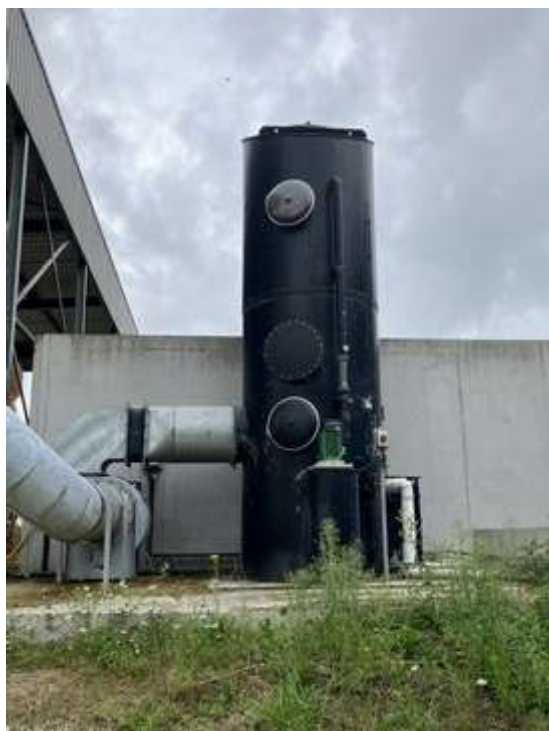
Tour de lavage de l'unité de désodorisation
