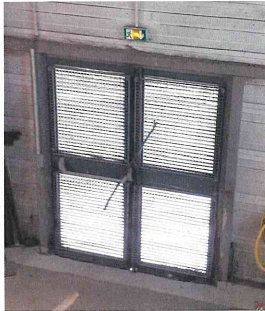
Figure 1: Présence d'un pied de biche sur l'un des accès de la chaufferie biomasse
