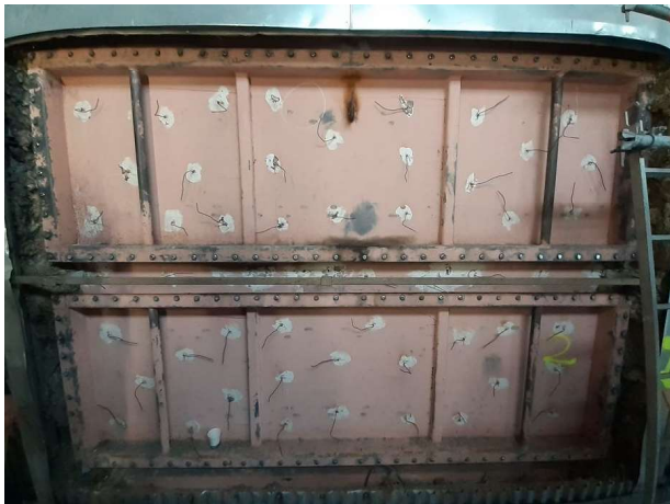
Catalyseur de la ligne 1
