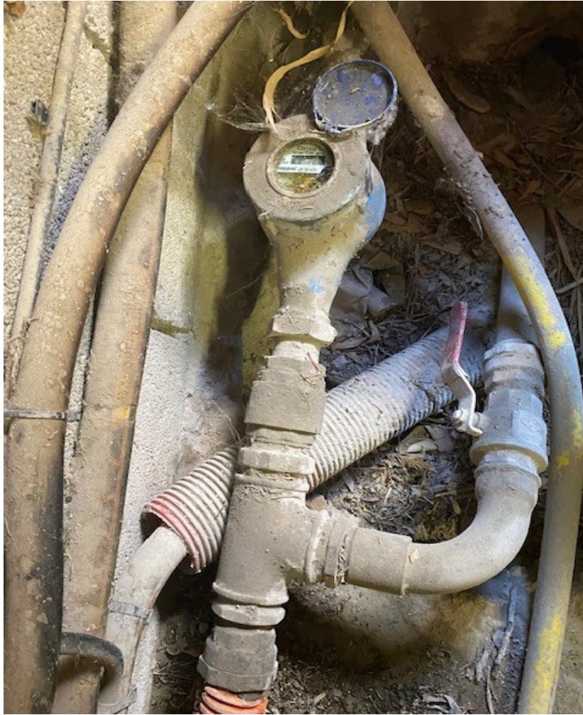
Photo n°5 – compteur du forage présent dans un local technique
