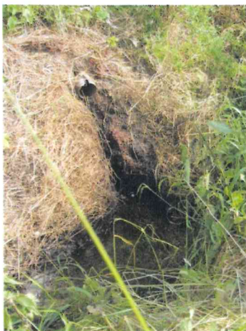
Point de rejet eaux usées non traitées provenant du regard de la fosse de décantation
