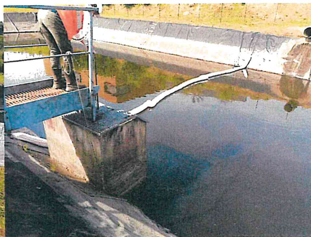
Photo 2 : Personnel du site en cours de manoeuvre de la vanne d'isolement du bassin ouest
