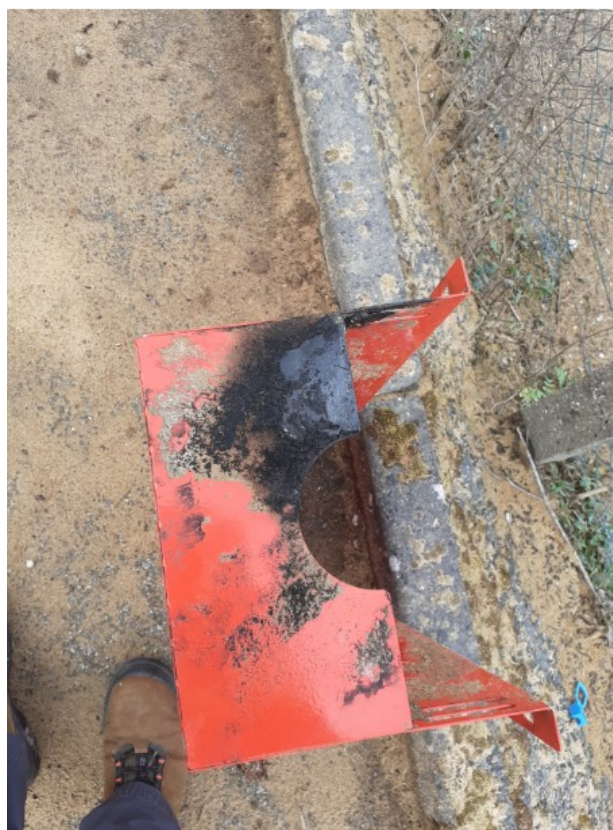
Carter de protection de la transmission du dispositif d'aspiration incriminé
