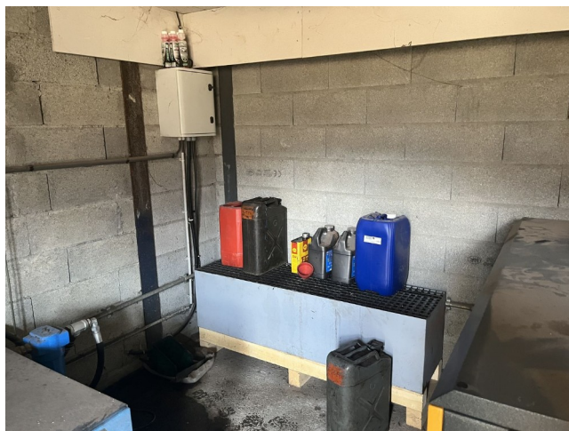
Rétention °3 (local compresseur)
