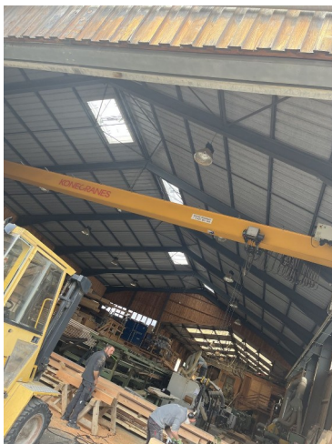
Emissaires de désenfumage
