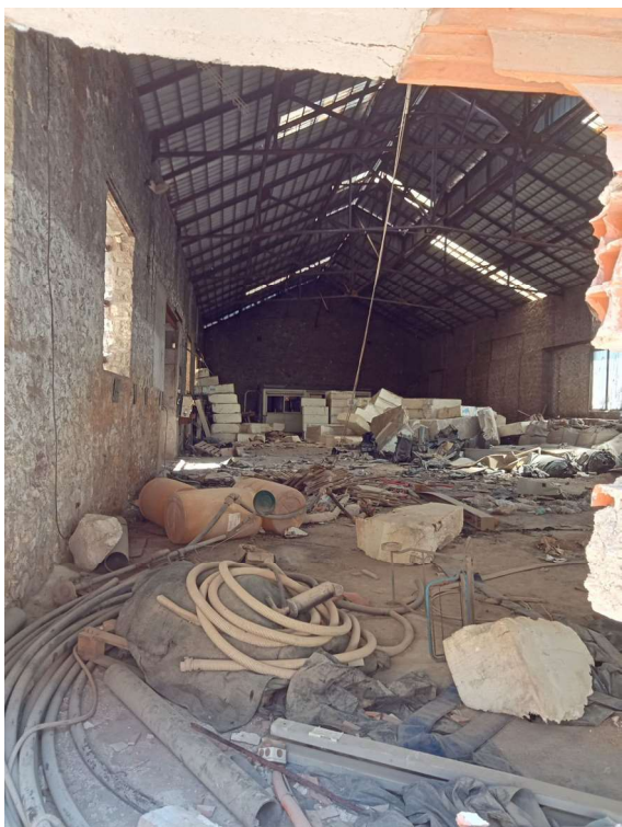
Déchets dans le bâtiment 31
