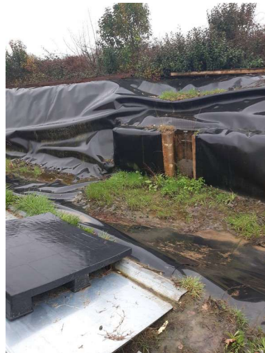
Bassin de confinement des eaux d'extinction actuellement en place, inopérant et non entretenu
