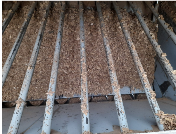
Plaquettes de bois - Trémie sous le silo de bois
