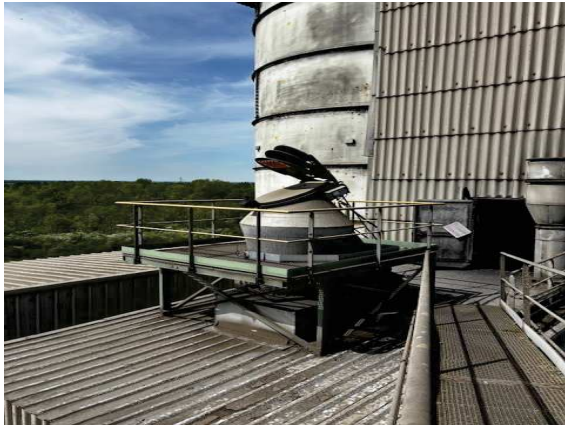
Clapet de décharge sur canalisation DIS
