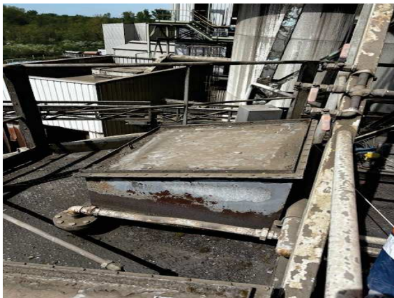
Évent - silos DIS
