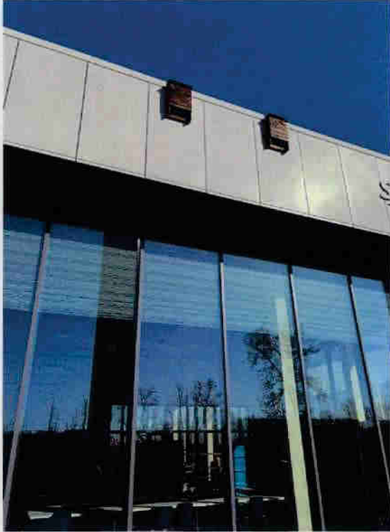
Dispositifs anti-collision sur les parois vitrées des bâtiments
