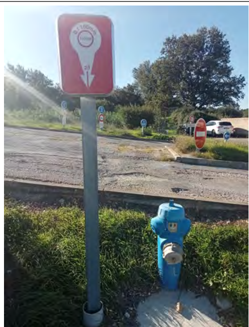
Poteau incendie d'aspiration à l'entrée du site
