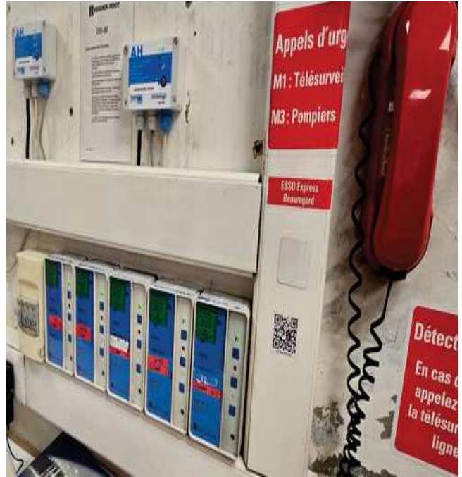
Photo 5 : boîtiers de détecteur de fuite
