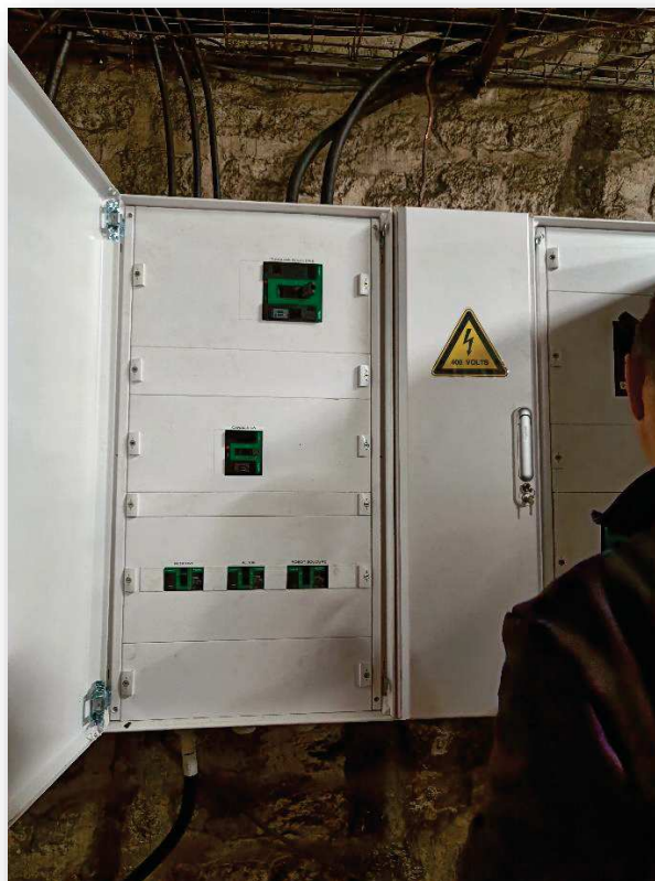
Figure 1 : Armoire neuve fermée local transformateur 250 kVA
