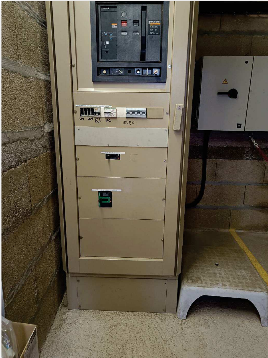
Figure 6 : Poste de livraison
