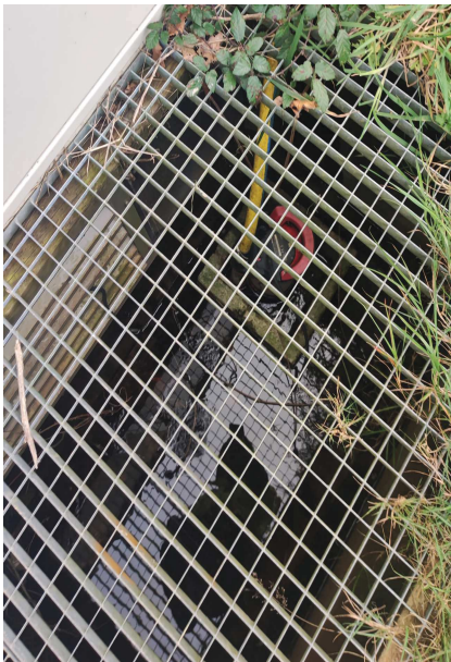
Présence d'eau dans le regard avec la pompe fonctionnant en continu
