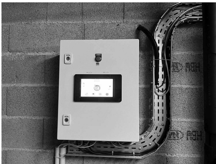
Pupitre de commande du système de détection de fuites.
