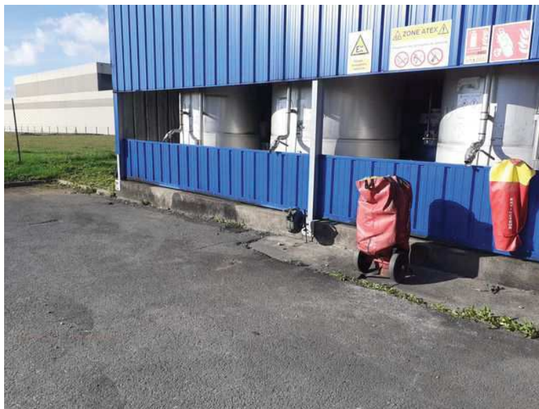
Aire de chargement des cuves de solvants
