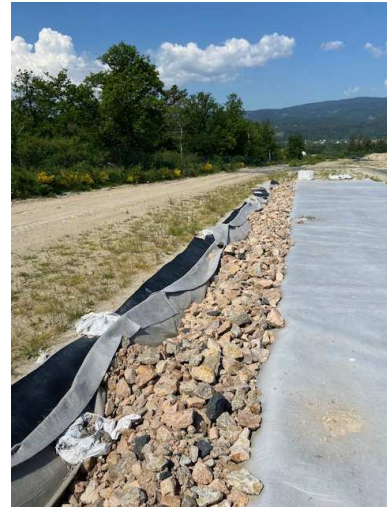
Ancrages des la BSA
