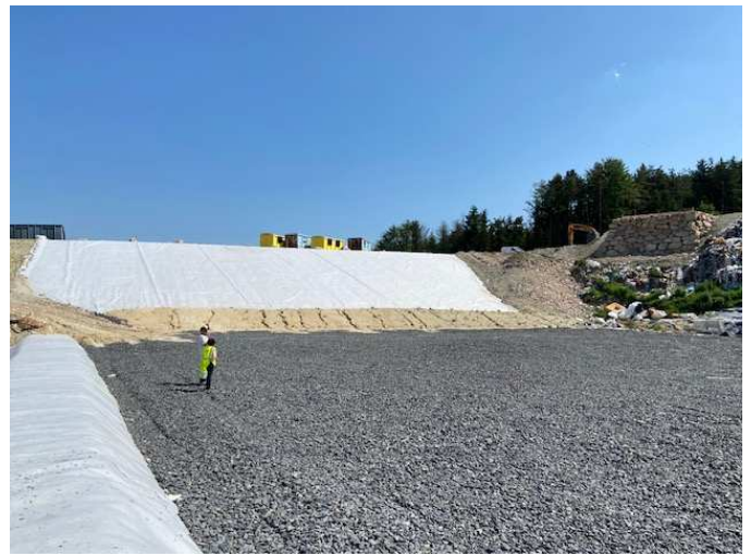
Couche drainante et quai de vidage
