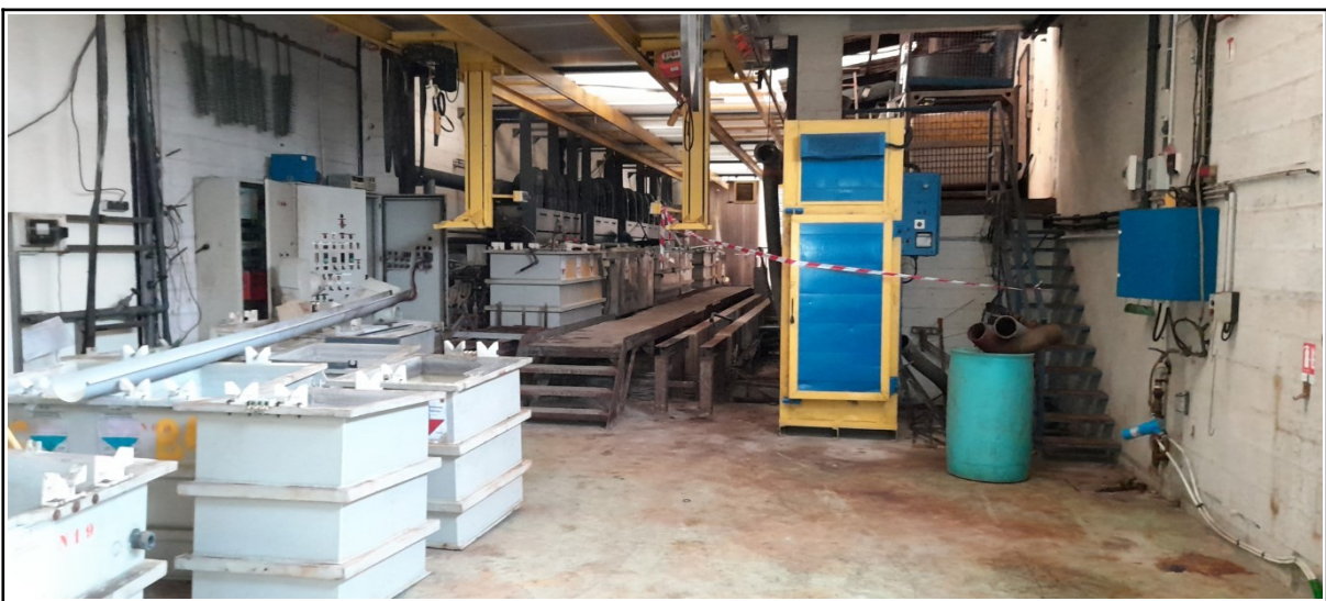
Photo N°3 : Vue de la chaîne de nickelage
