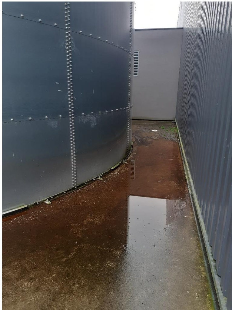
Figure 6 : Réservoir B du système d'extinction automatique d'incendie du bâtiment 3
