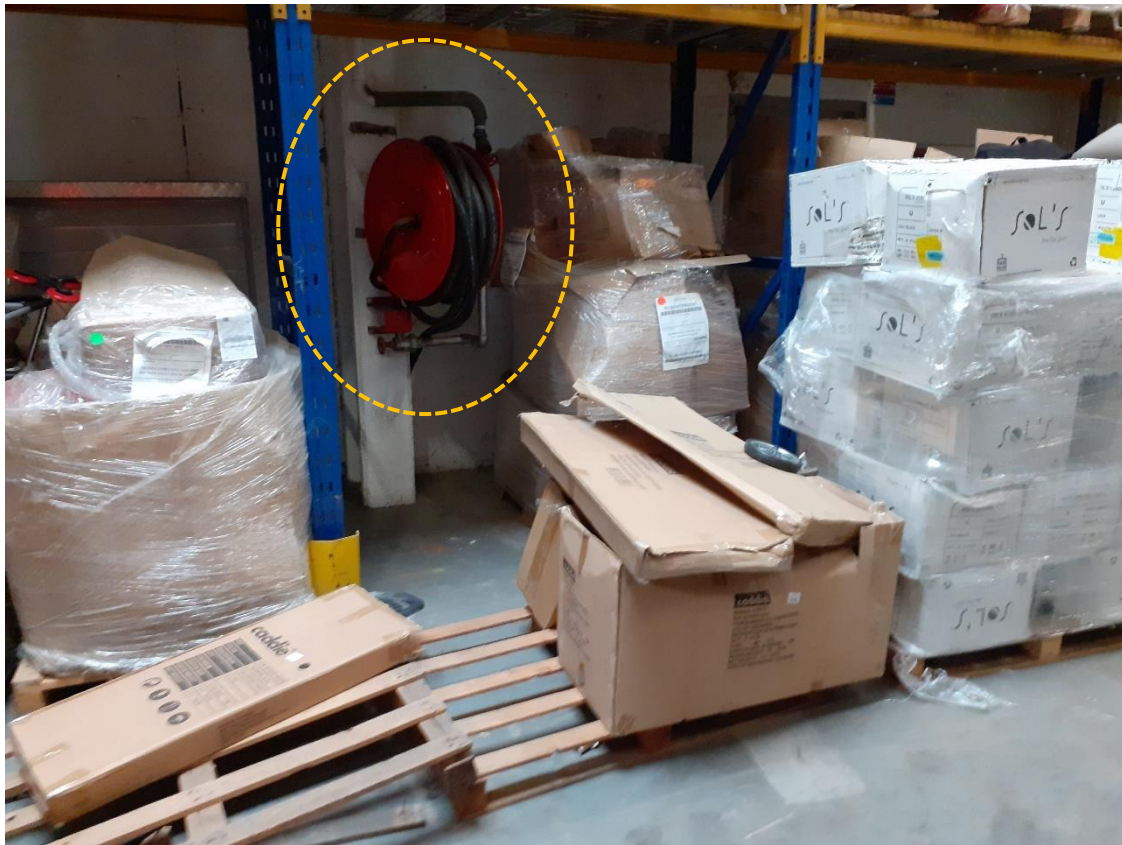
Figure 9 : Robinet d'incendie armé situé dans la cellule 2 du bâtiment 2
